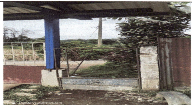
Foto 3: Portón de ingreso principal del centro educativo en mal estado.
