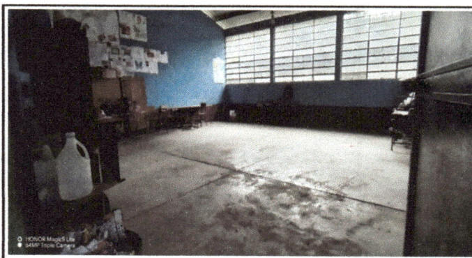
Foto 4: Piso de aula No. 4 del módulo 1 en malas condiciones que necesita ser sustituido.
