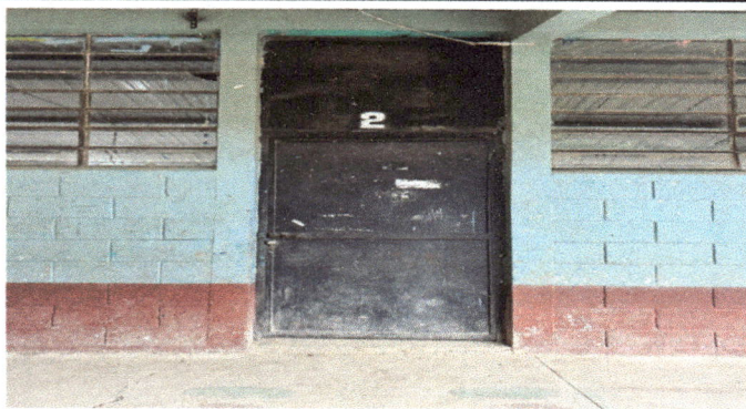
Foto 1: Puertas en mal estado que necesitan mantenimiento del módulo 1.
