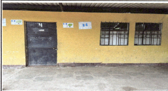
Foto 2: Puertas en mal estado que necesitan mantenimiento del módulo 2. Y pintura dañada en paredes
