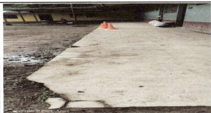
Foto 9: Torta de concreto del corredor en pésima condiciones que necesita ser sustituida.
