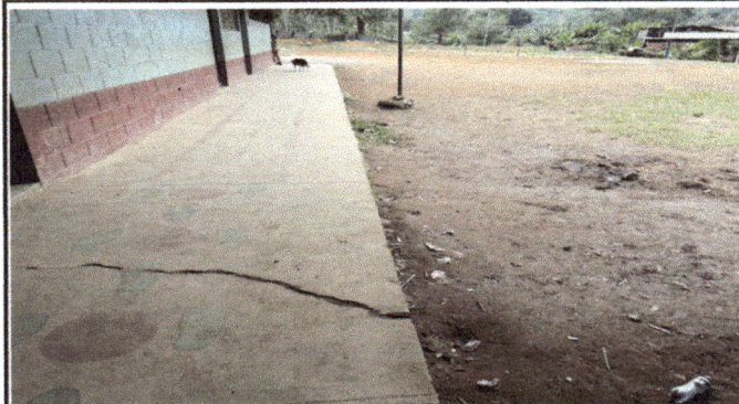
Foto 8: Torta de concreto del corredor agrietada que necesita ser sustituida.
